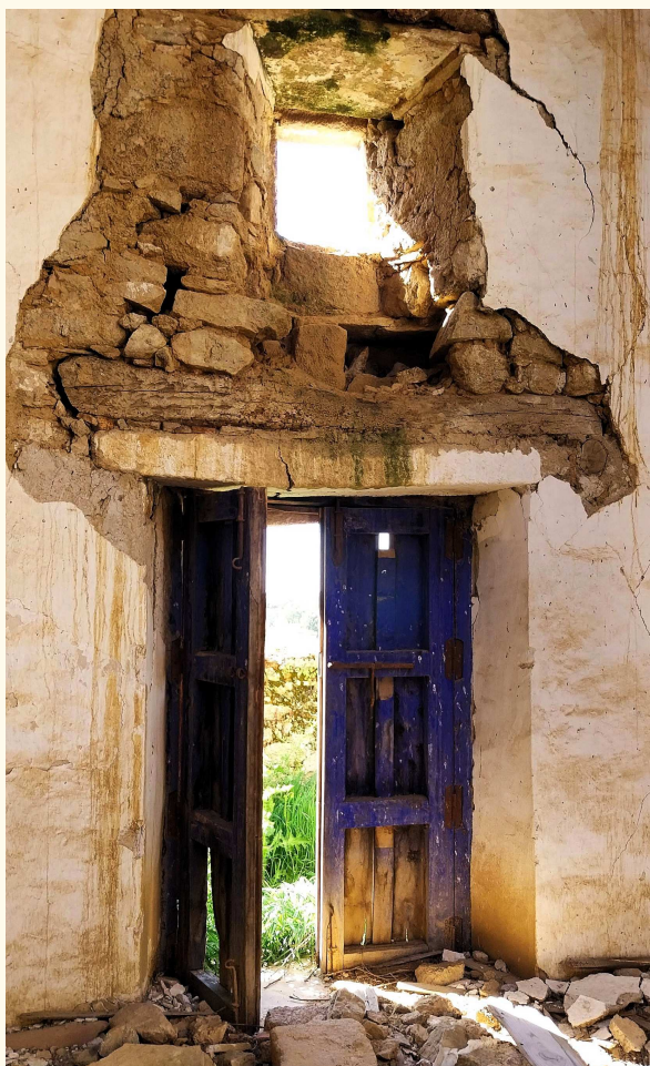
Puerta de entrada al oratorio de la Dehesa de la Albañeza. Se puede apreciar el significativo deterioro en el que se encuentra. Fotogr. MSF.
